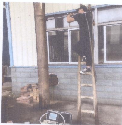
图-2 燃气锅炉排气筒出口采样
